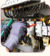
MAINTENANCE OF ELECTRICAL INSTALLATIONS विद्युत प्रतिष्ठानों का रखरखाव
